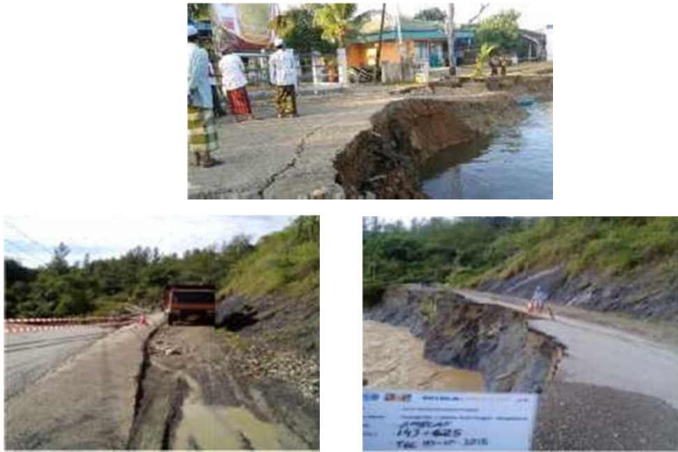
Gambar 53. Kasus Abrasi Sungai yang berdampak pada Hilangnya Sebagian Jalan
