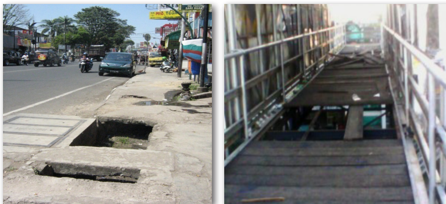
Gambar 4-4 Kondisi Fasilitas Pejalan Kaki Yang Rusak
